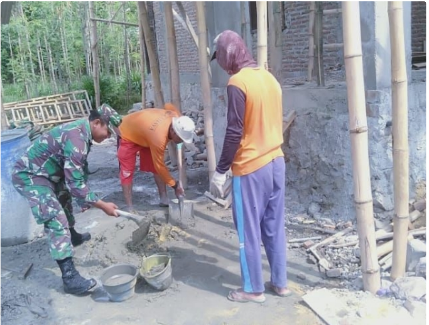
Babinsa Serma Rudi anggota Koramil 08/Keling bantu ringankan beban warga dalam pengerjaan rumah warga
